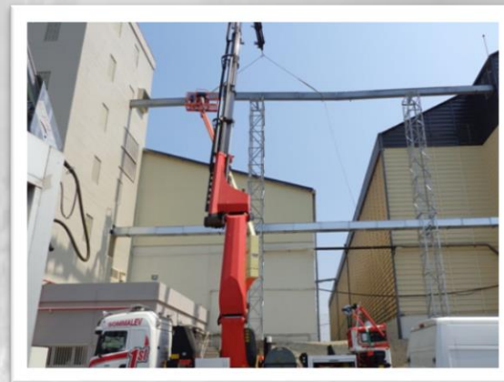
Montage redler aérien avec ses 2 tours support
